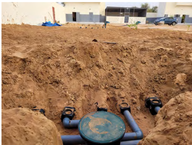
Boîte de distribution du System O))
